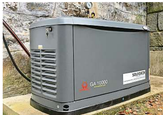
Jednotka GA10000 umístěná na betonové desce. 3x foto: Solforen Plus
