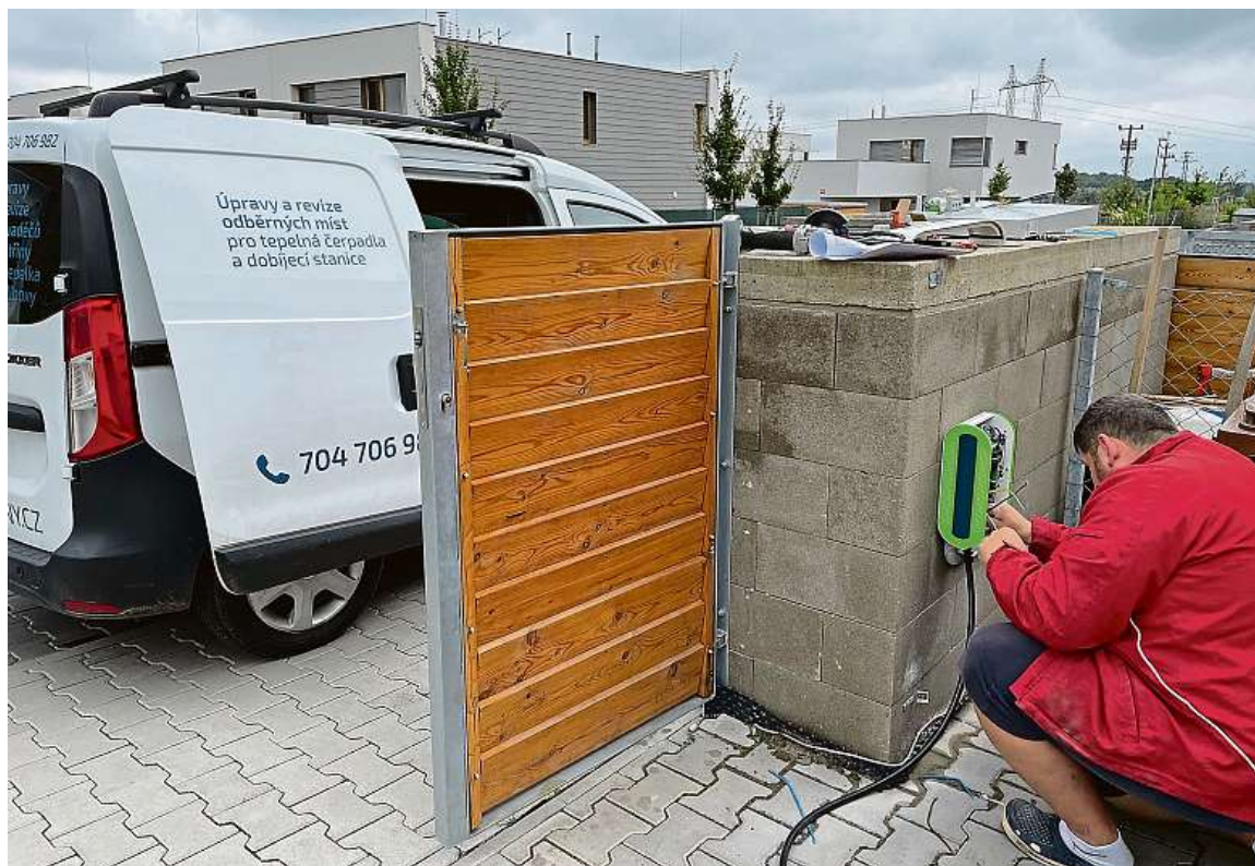
Příprava Při připojení domácího nabíjení je třeba dodržet několik podmínek. Foto: Přípojky elektřiny
