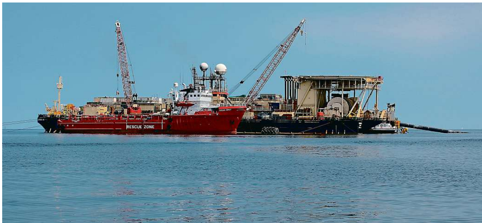
Nord Stream II Loď Castoro Dieci slouží k pokládání potrubí pro plynovod Nord Stream II. Foto: nord-stream.com
