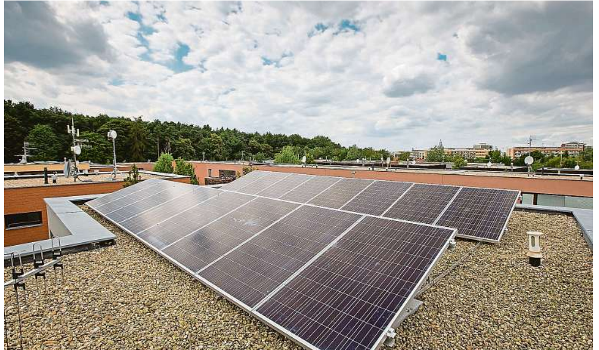
Dotace Na fotovoltaiku i na bateriový systém je možné získat dotaci. Veškerou administraci spojenou s vyřízením dotace zajišťují za zákazníka odborníci z ČEZ. Foto: ČEZ
